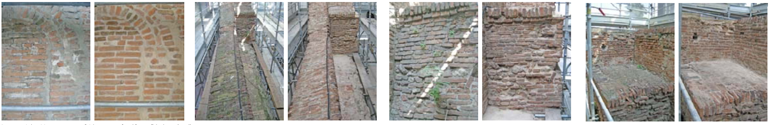
Paramento in laterizio, copertura superficiale e arco: confronti fotografici prima e dopo il restauro.
