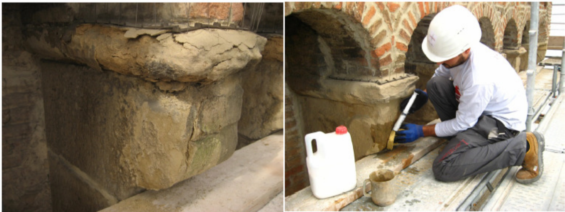
FIG. 6 e 7– Porta San Donato, Immagine prima del restauro: particolare del degrado dell’arenaria e particolare durante il consolidamento.
