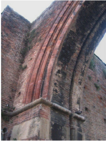
FIG. 5 – Porta Maggiore, Immagine prima del restauro: particolare del degrado sui mattoni e sull’arenaria.
