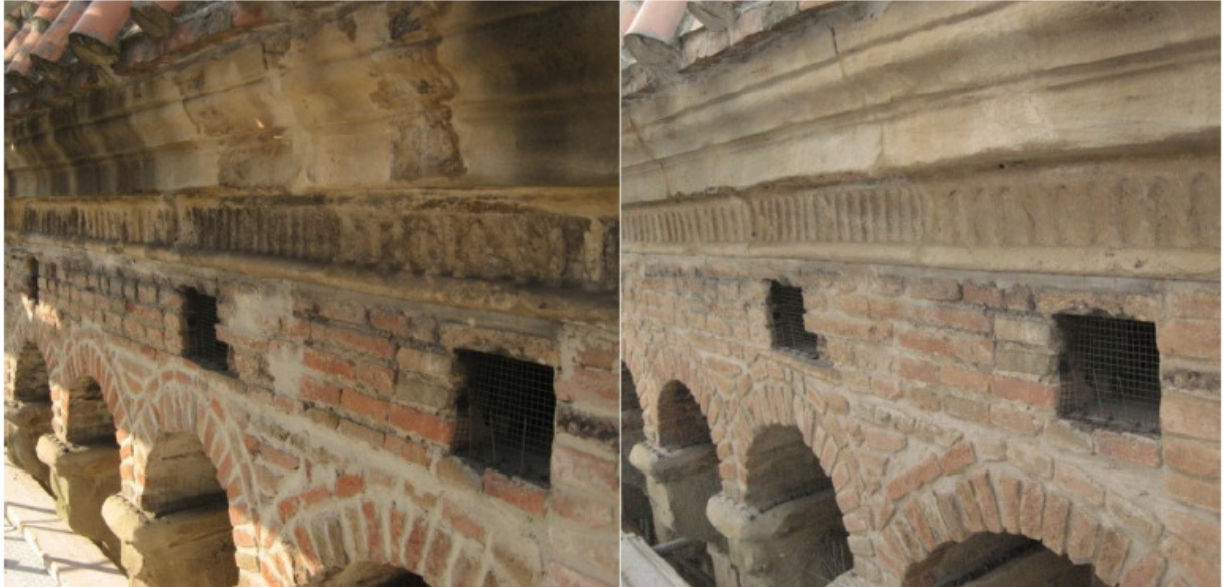
FIG. 13– Particolare di una muratura in cotto e arenaria a confronto prima e dopo il restauro .
