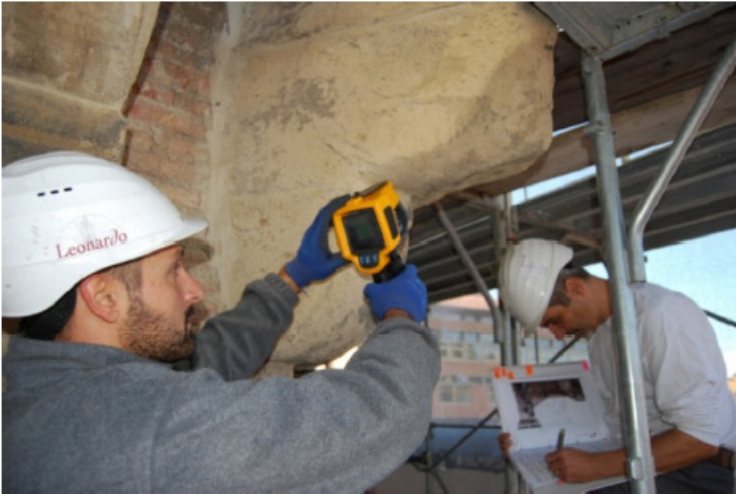
FIG. 1 – Porta San Donato, Analisi termografica dell’arenaria per misurare il grado di umidità presente nella pietra.
